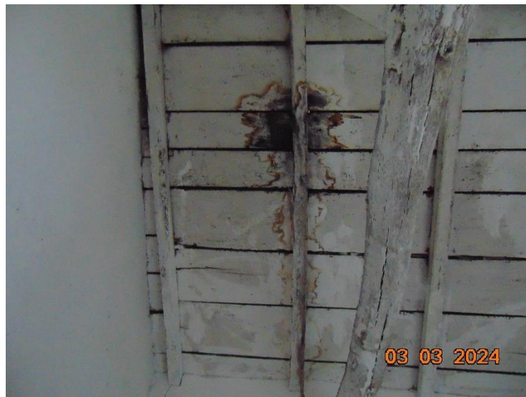
Daños ocasionados por el deterioro en la cubierta (goteras, cubiertas deterioradas)
