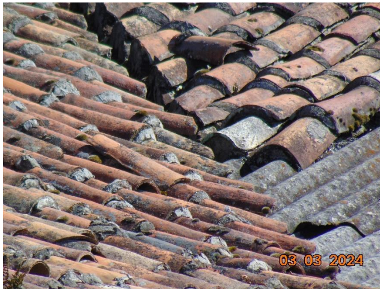
Area de cubierta deteriorada.
