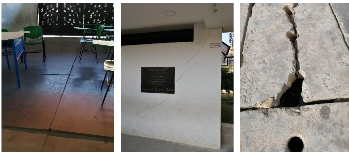
Imágenes de la visita de inspección de Findeter a la obra el 19 de diciembre de 2019, donde se ve levantamiento y fractura de losas de piso, grietas en muros y fractura de cárcamos
