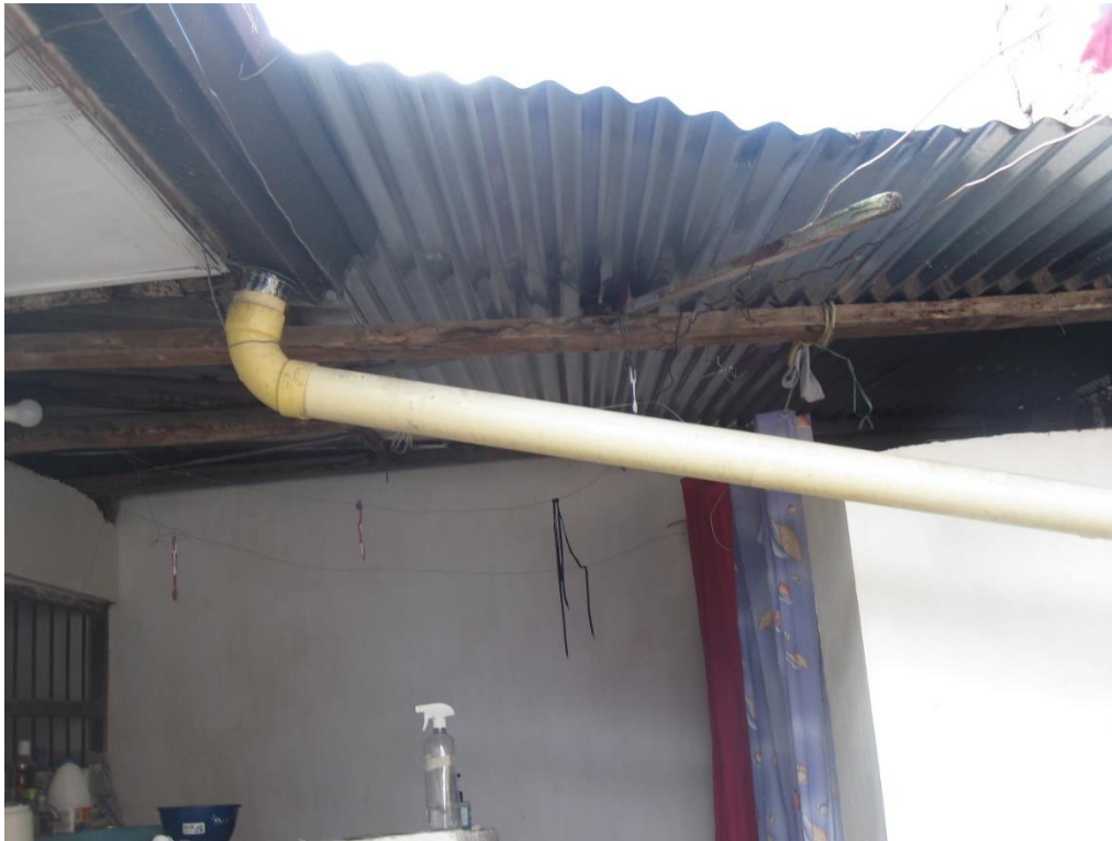
Fotografía No. 13.- Cielo raso zona de baño, sanitario y lavader
