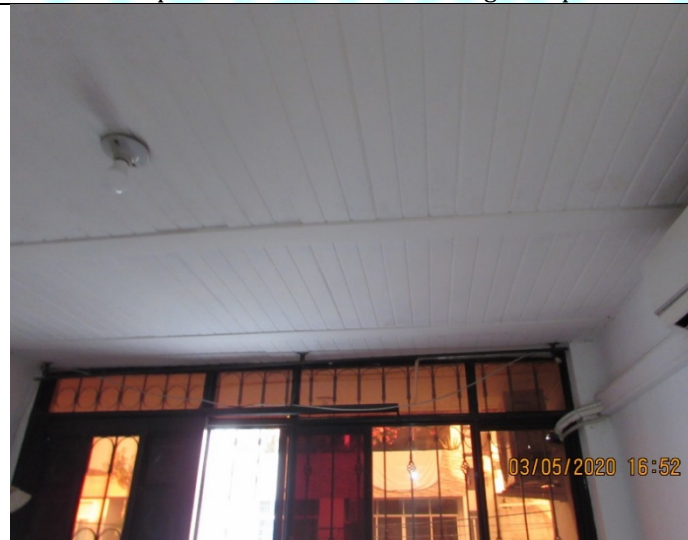
IMG31 Placa aligerada habitación N°2 segundo piso
