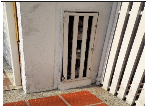
Contador de gas
