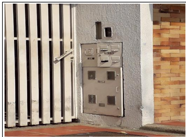
Contador de energía
