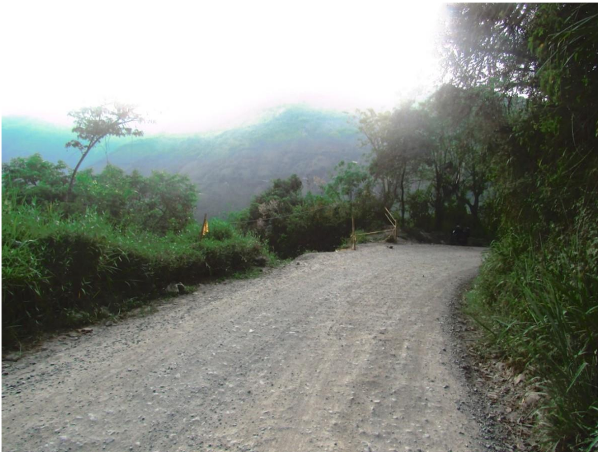
FOTOGRAFIA No.3: fotografía tomada en sentido Salamina – Pacora vereda Rungano, donde se observan las características de la vía, estado, ausencia de demarcación, señalización y elementos de seguridad.
