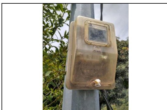
CONTADOR DE ELECTRICIDAD
