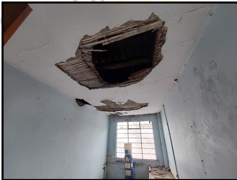
Cielo raso desprendido
