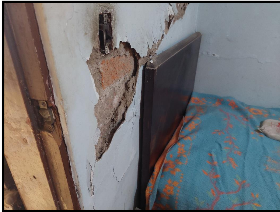
Desprendimiento de acabados
