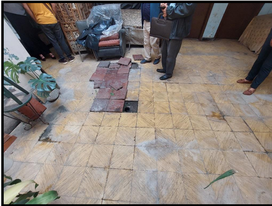
Pisos en mal estado
