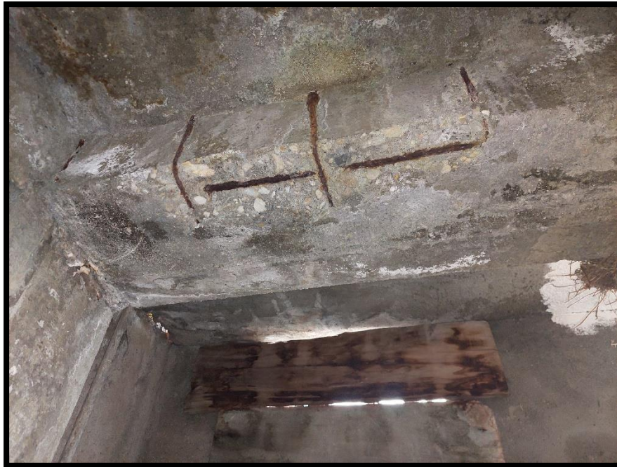
Acero de refuerzo oxidado
