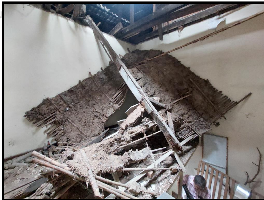
Cielo raso desplomado
