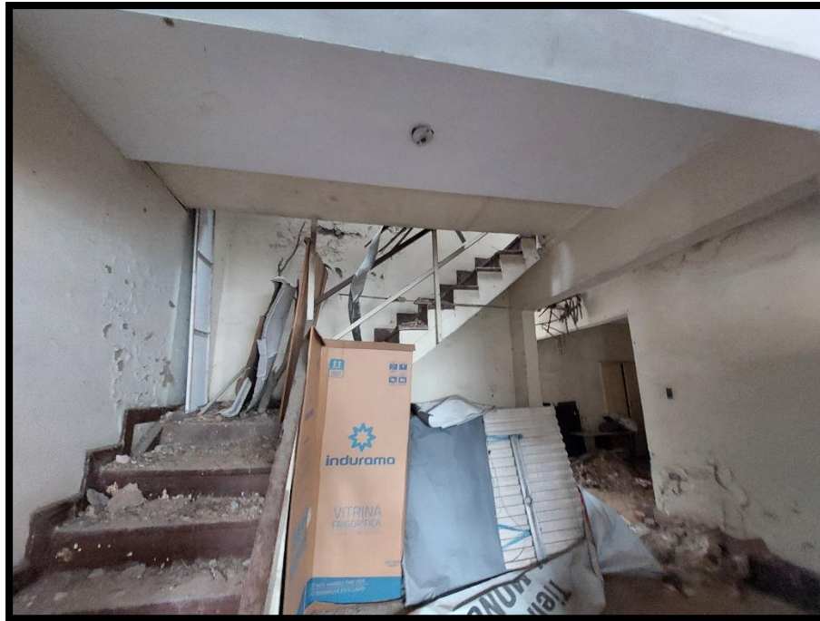
Acumulación de escombros
