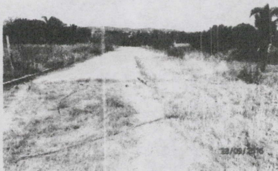
VIA DE ACCESO PAVIMENTO AL INGRESO A LOS LOTES SIN PAVIMENTO, ENMALEZADO.
