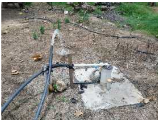
Foto No.7 Pozo profundo instalado.
