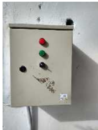
Foto No.8 Instalaciones del pozo
