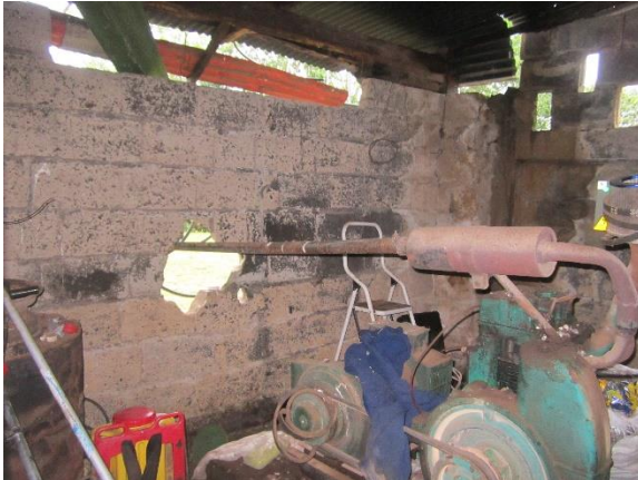
Cuarto de máquinas.
