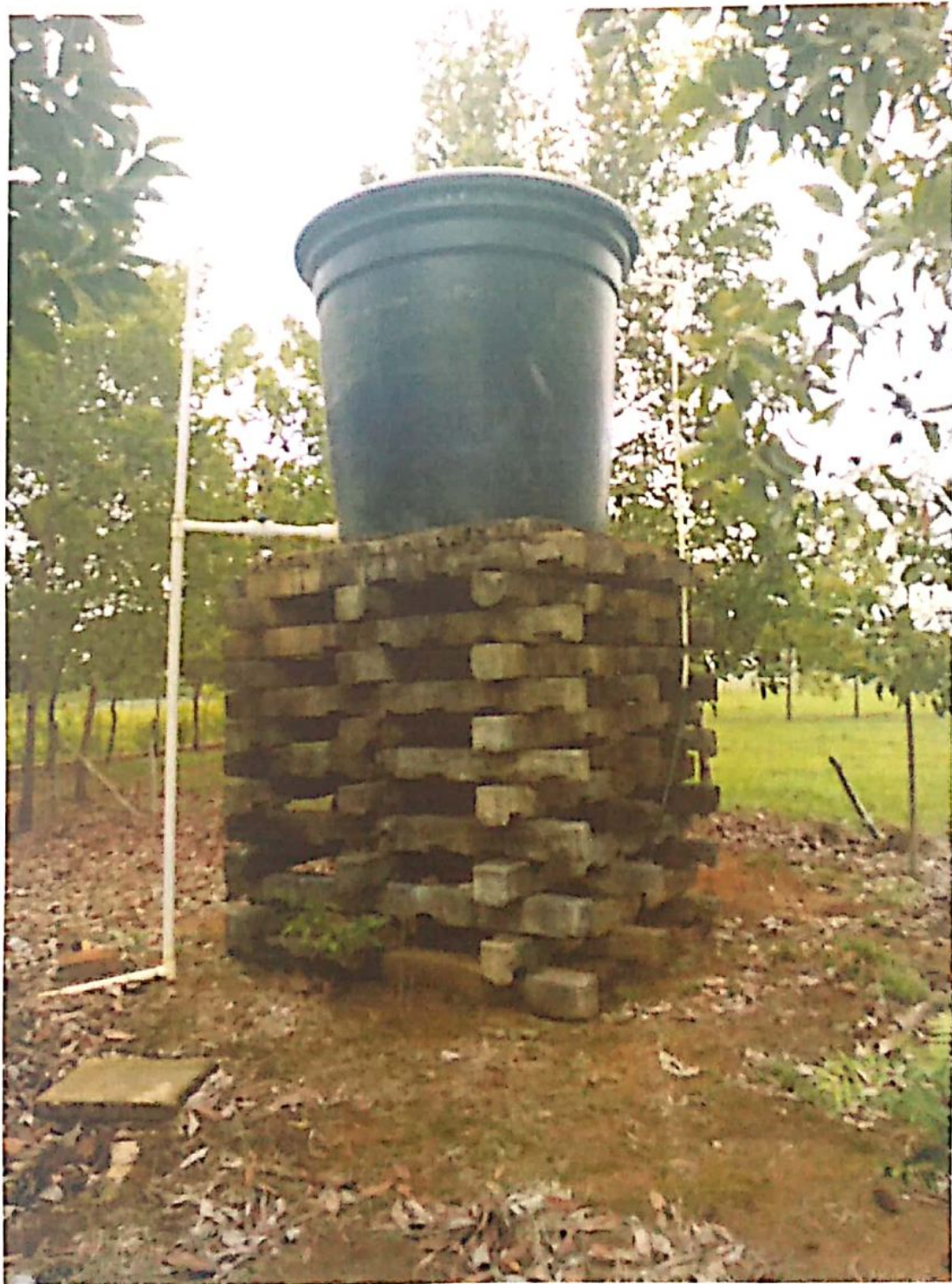
TANQUE DE ALMACENAMIENTO
