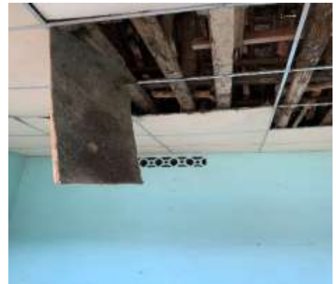
VIGAS DEL TECHO PODRIDAS
