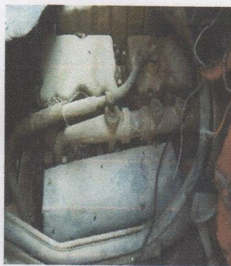
VISTA DE LA REFRIGERACION
