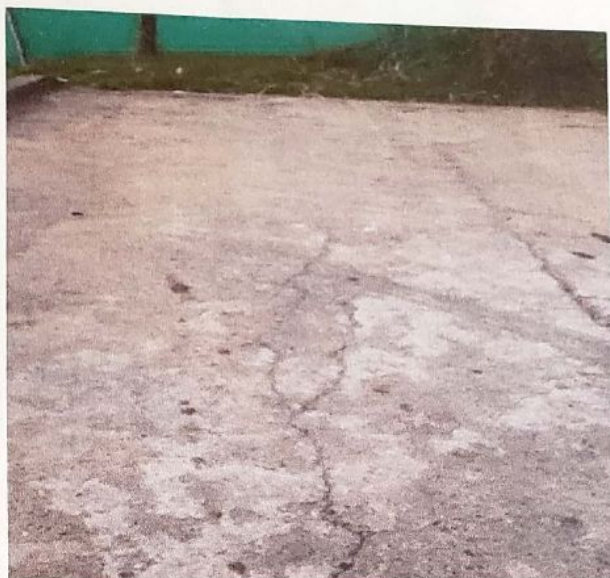
Perjuicio causado por el movimiento de tierras de la constructora Hungría y TM S.A. Al interior del Lava Autos.
