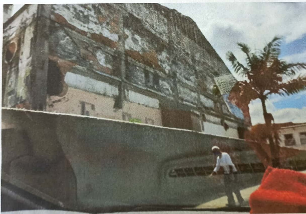
Vista general estado en ruinas
