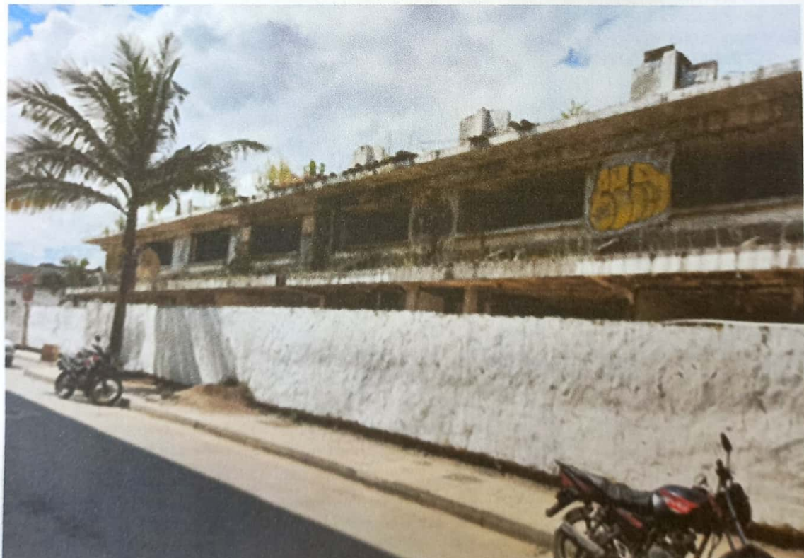
El inmueble presenta deterioro con presencia de malezas
