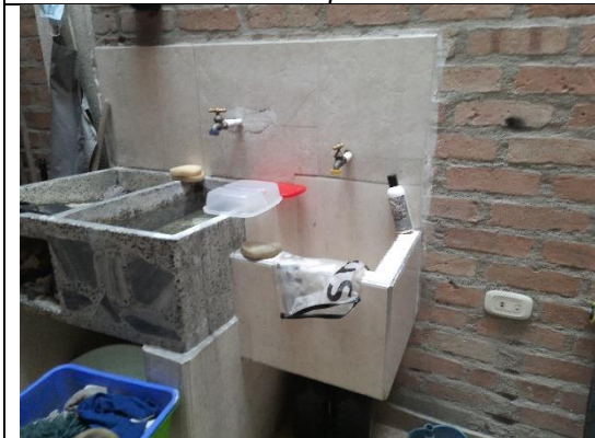
Lavadero en piso 1 para zona habitacional
