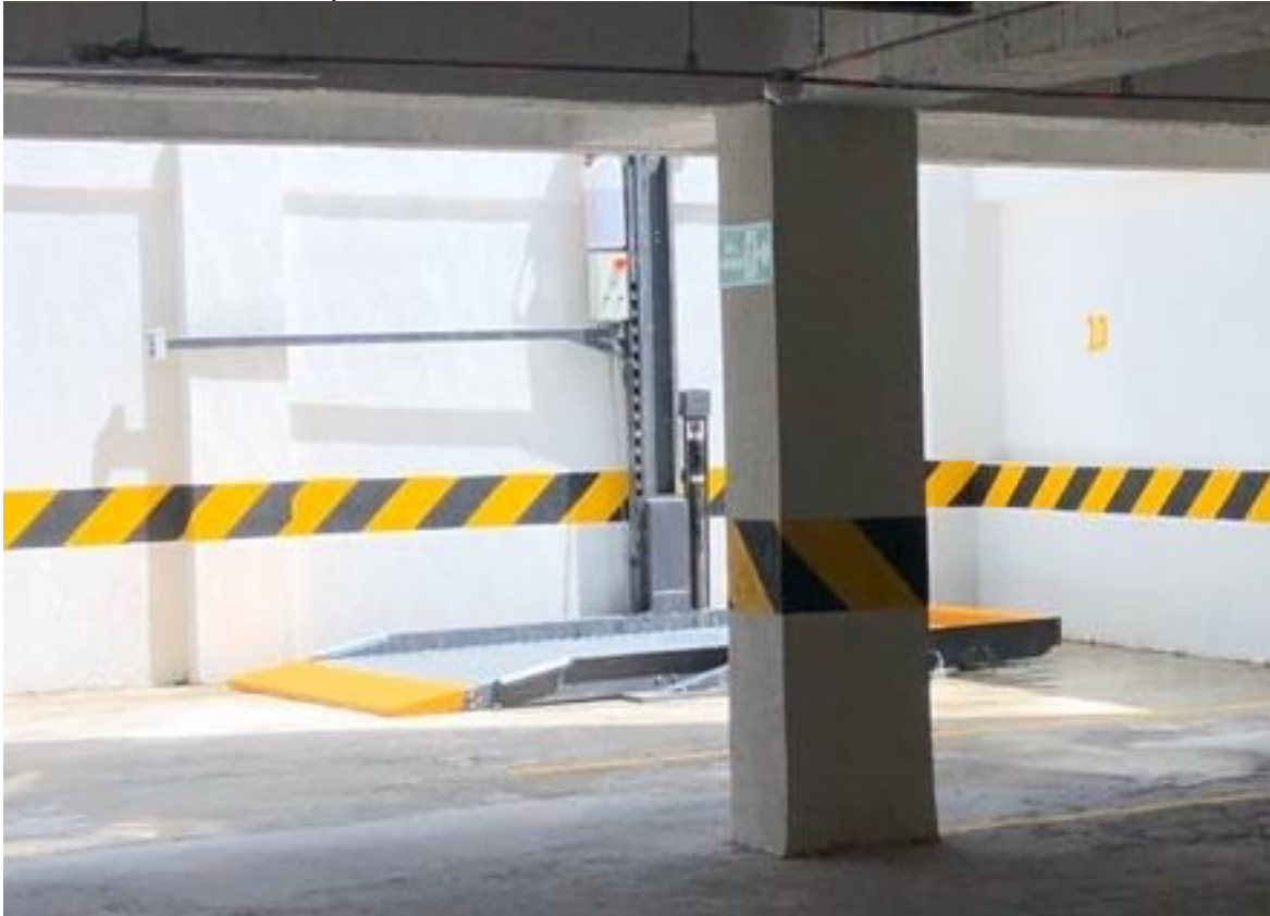
Foto 1, DUPLICADOR DE VEHÍCULOS INSTALADO EN PARQUEADERO #10
