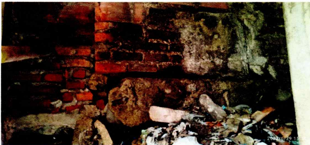
Deterioro del muro del patio por el lado de la quebrada
