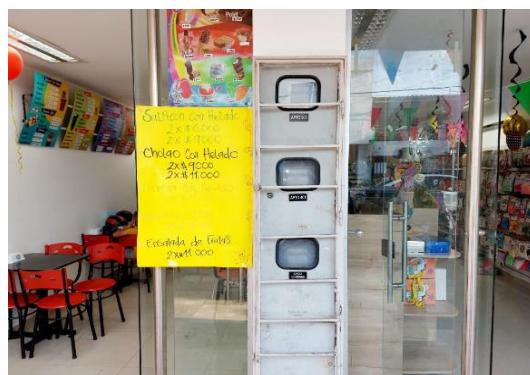
CONTADOR DE ENERGIA
