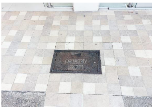
CONTADOR DE AGUA
