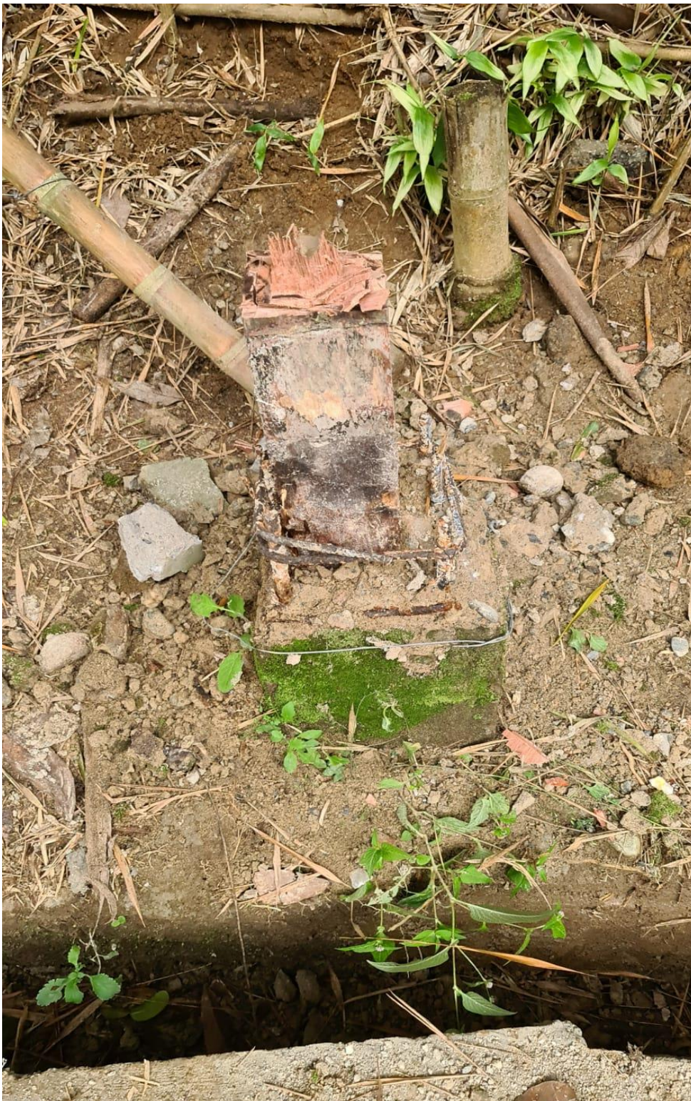
IMAGEN DE LOS DAÑOS CAUSADOS POR EL DEMANDANTE AL PORTON DE LA PARCELA VILLA CRISTAL
