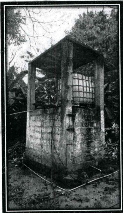
TANQUE DE AGUA
