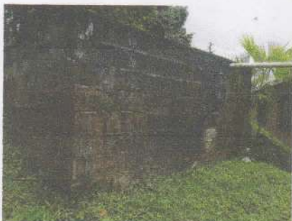
3 tanques de almacenamiento de agua
