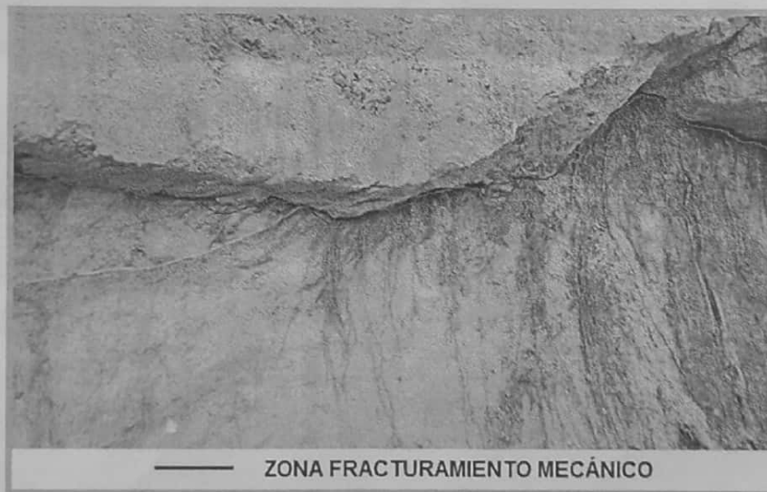
Figura 4. Zona de fracturamiento por expansión de grietas generadas por raíces generando roturas y desprendimiento rocoso.
