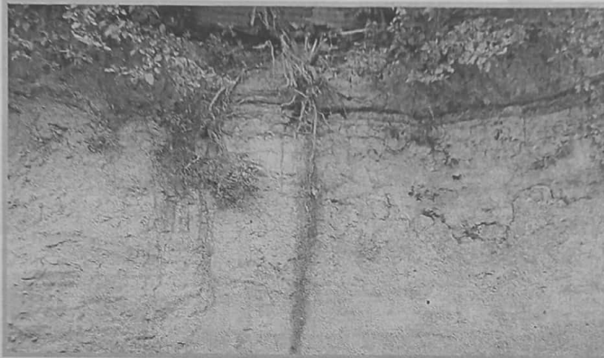
Figura 3. Parte superior del talud, evidencia de meteorización física por raíces.
