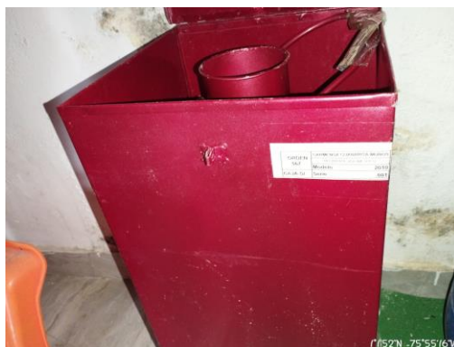
Tanque del medidor volumétrico
