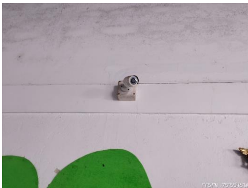
Cámaras de seguridad
