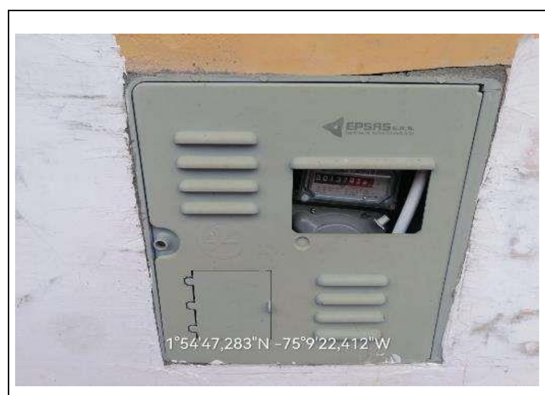
CONTADOR DE GAS
