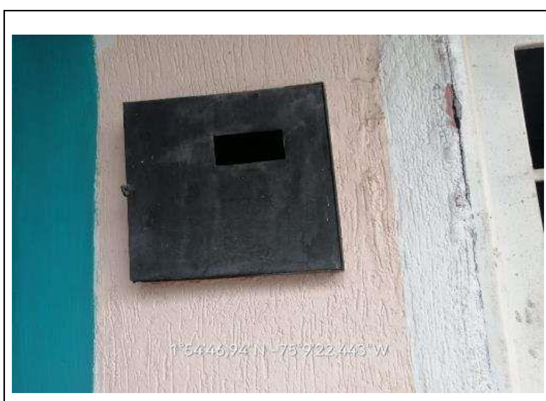
CONTADOR DE ENERGÍA
