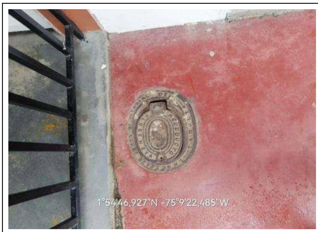
CONTADOR DE AGUA
