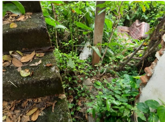
Malezas altas en solar- escalera
