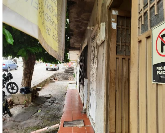
Fachada en mal estado
