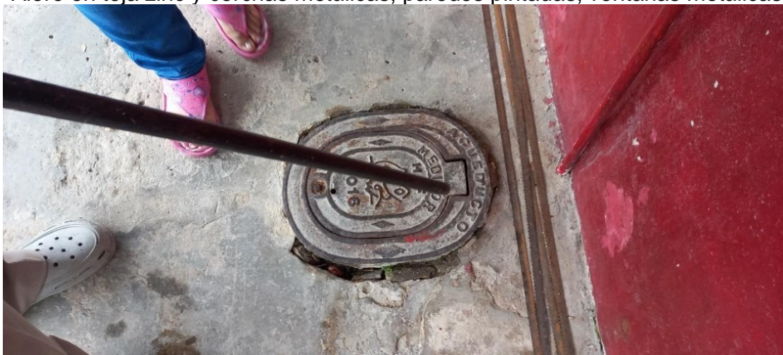
Medidor acueducto, piso en cemento, paredes pintadas
