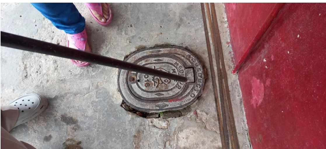
Medidor acueducto, piso en cemento, paredes pintadas
