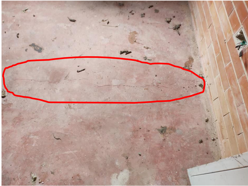
Fisuras en el piso de la vivienda
