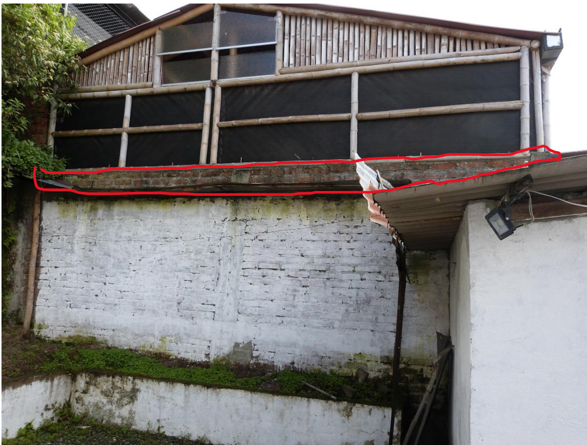
MURO DEL PREDIO DE LA DEMANDANTE Y CONSTRUCCIÓN SOBRE EL
