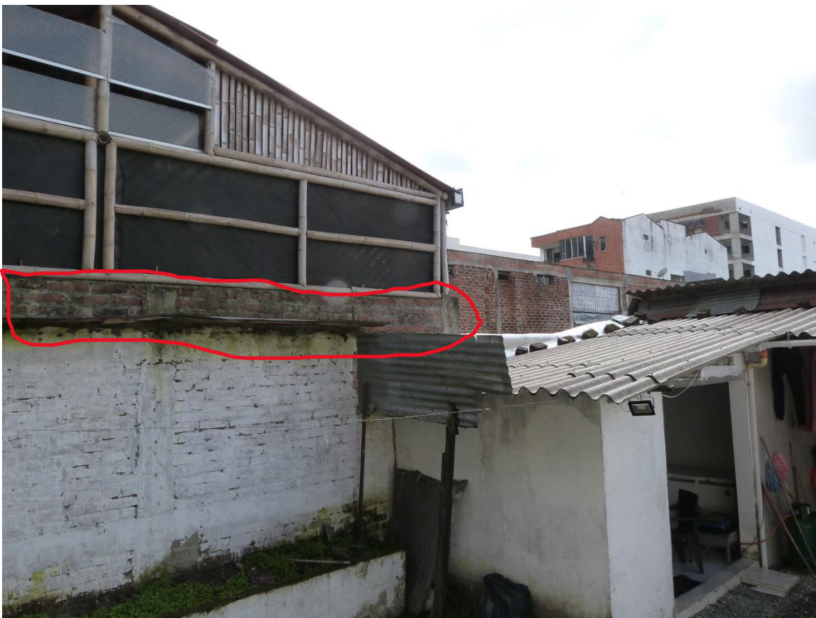
MURO DE LA DEMANDANTE Y CONSTRUCCIÓN SOBRE EL
