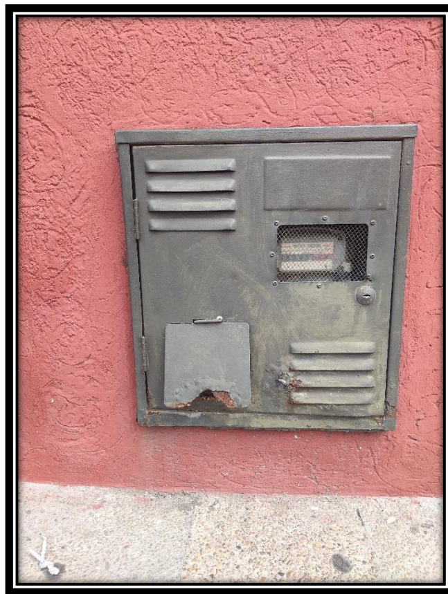
CONTADOR GAS DOMICILIARIO
