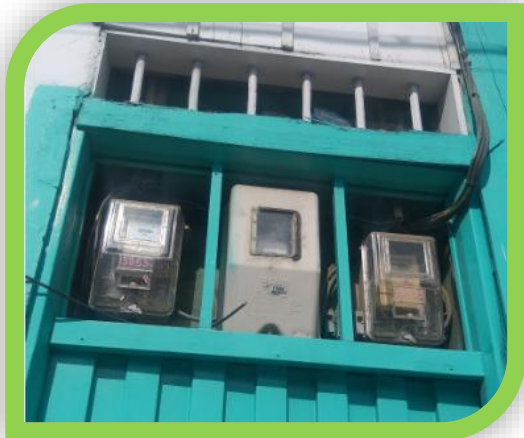
CONTADOR DE ENERGÍA
