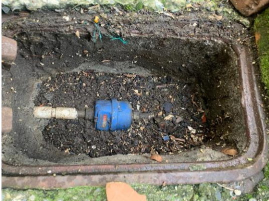
MEDIDOR DE AGUA
