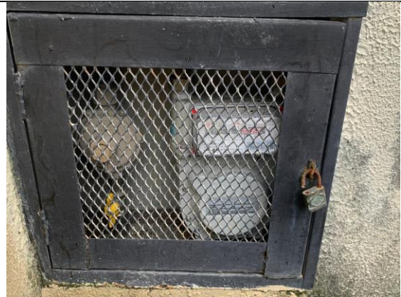
MEDIDOR DE GAS
