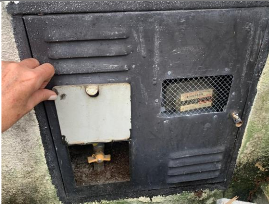
MEDIDOR DE GAS
