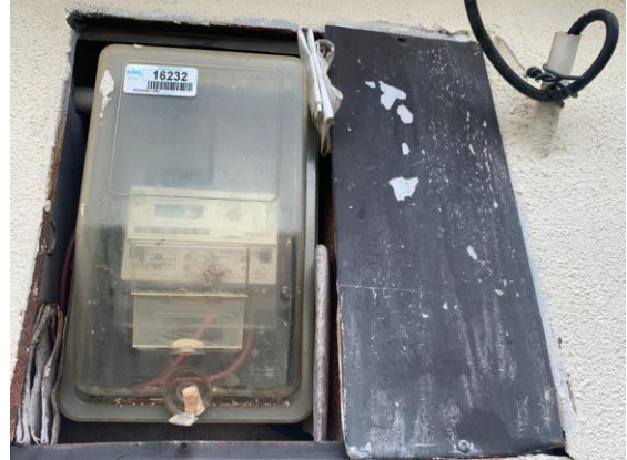
MEDIDOR DE ENERGIA
