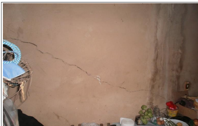
IMAGEN No. 10 DE 18 FECHA: 14/9/2021 CONTIENE: Estado muro cocina
