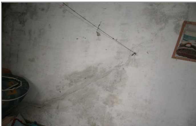
IMAGEN No. 15 DE 18 FECHA: 14/9/2021 CONTIENE: Estado muro sala
