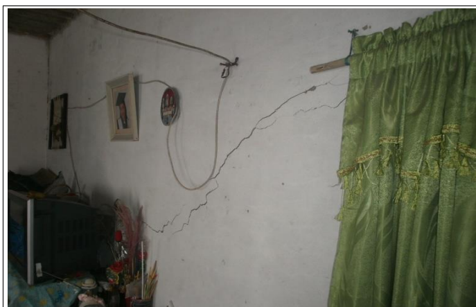
IMAGEN No. 11 DE 18 FECHA: 14/9/2021 CONTIENE: Estado muro sala
