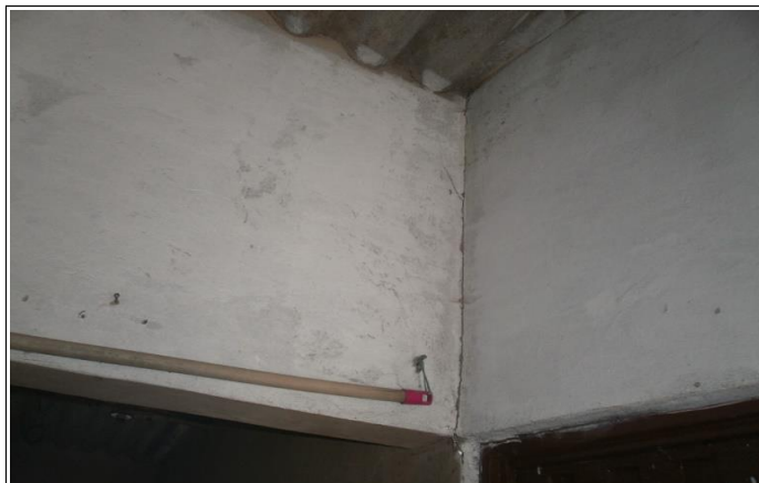
IMAGEN No. 14 DE 18 FECHA: 14/9/2021 CONTIENE: Estado muro sala
