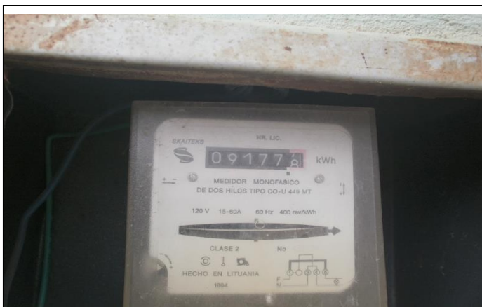
IMAGEN No. 17 DE 18 FECHA: 14/9/2021 CONTIENE: Medidor de energía
