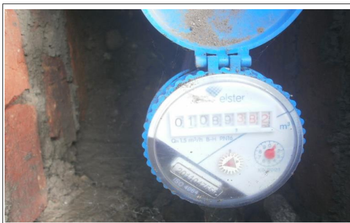
IMAGEN No. 18 DE 18 FECHA: 14/9/2021 CONTIENE: Medidor de acueducto
