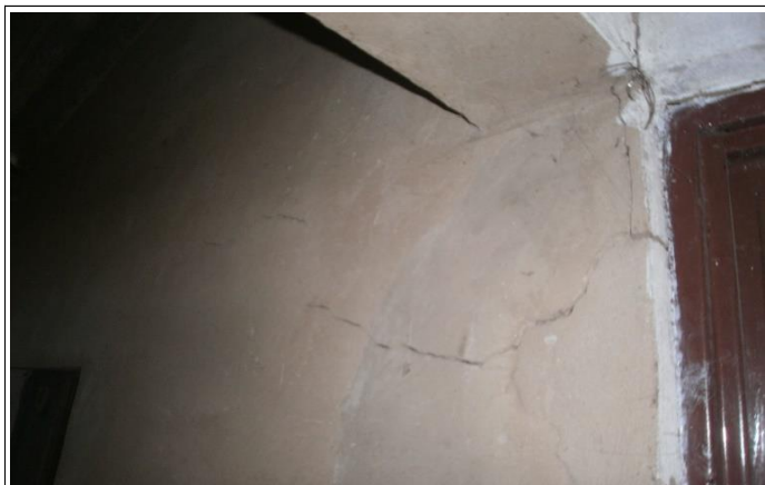
IMAGEN No. 13 DE 18 FECHA: 14/9/2021 CONTIENE: Estado muro sala
