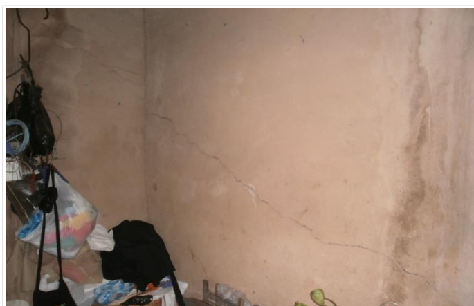
IMAGEN No. 12 DE 18 FECHA: 14/9/2021 CONTIENE: Estado muro cocina
