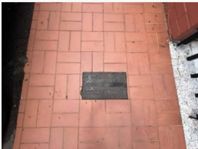
CONTADOR DE AGUA
