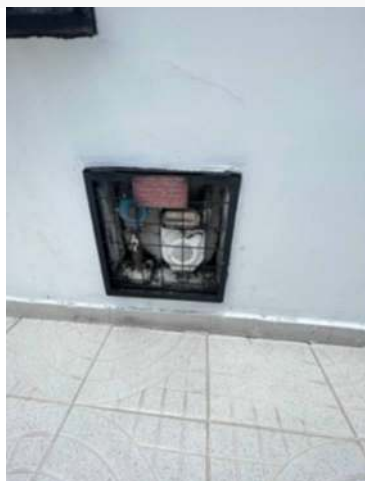
CONTADOR DE GAS
