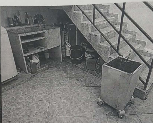
Foto No. 6. Evidencia de filtración
