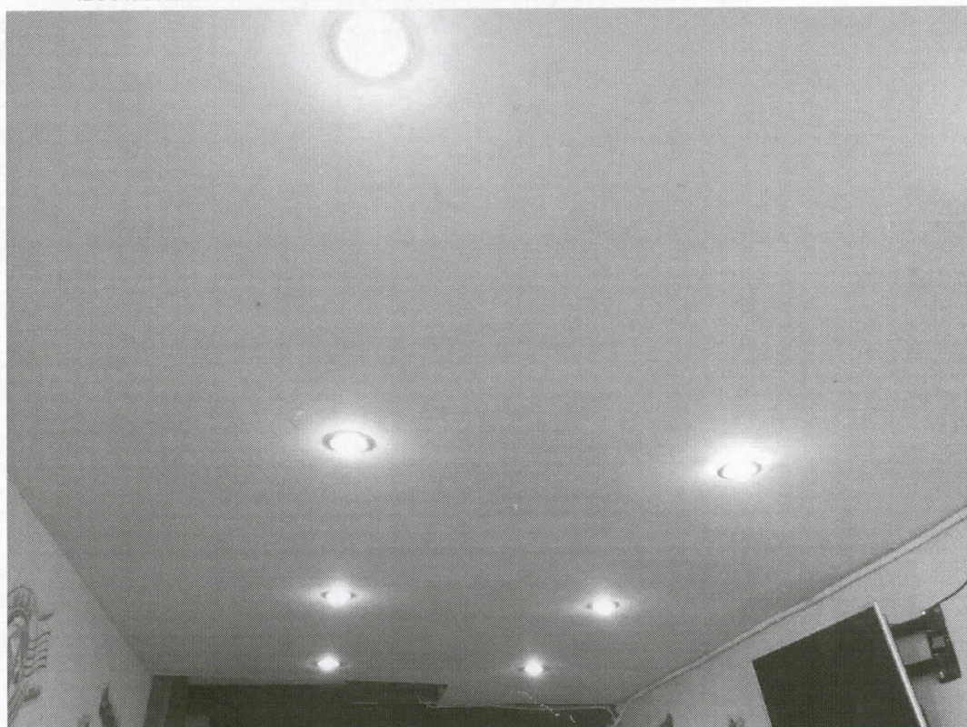
ILUSTRACIÓN 10: CIELO RASO EN DRYWALL DE AREA DE ATENCIÓN AL PÚBLICO
