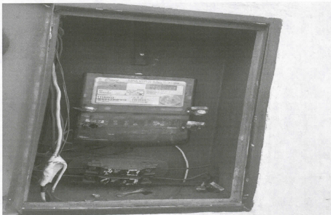
ILUSTRACIÓN 2: CONTADOR ELÉCTRICO LOCAL
