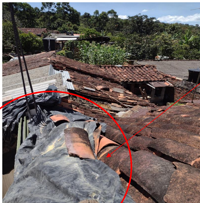
Foto del 26 de septiembre de 2021 (Fecha de captura que se toma de las propiedades de la imagen), se observa un plástico puesto sobre el techo del demandante para evitar que se filtre agua por ese costado,
