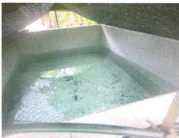
Foto No. 21. Tanque
