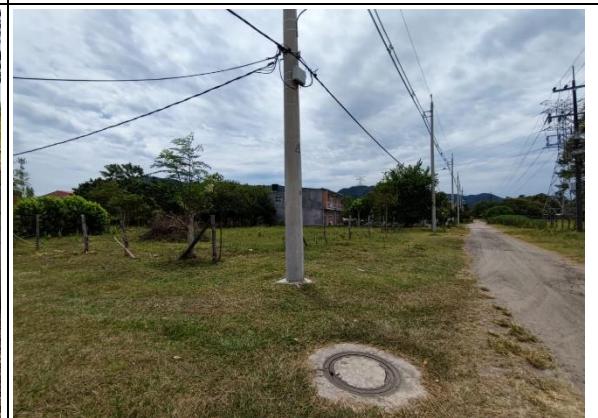
Vista Redes energía y pozo alcantarillado del centro poblado San Felipe
