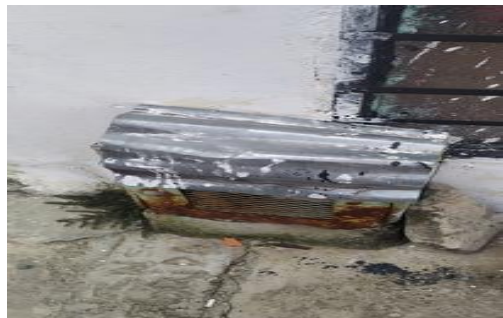
MEDIDOR DE GAS
