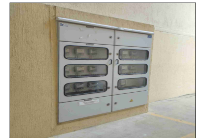
Foto Zona de contador de luz.jpg
