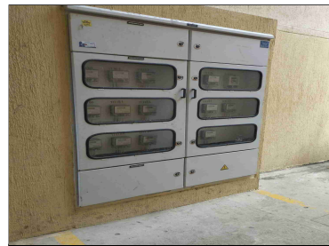
Foto Zona de contador de Luz .jpg
