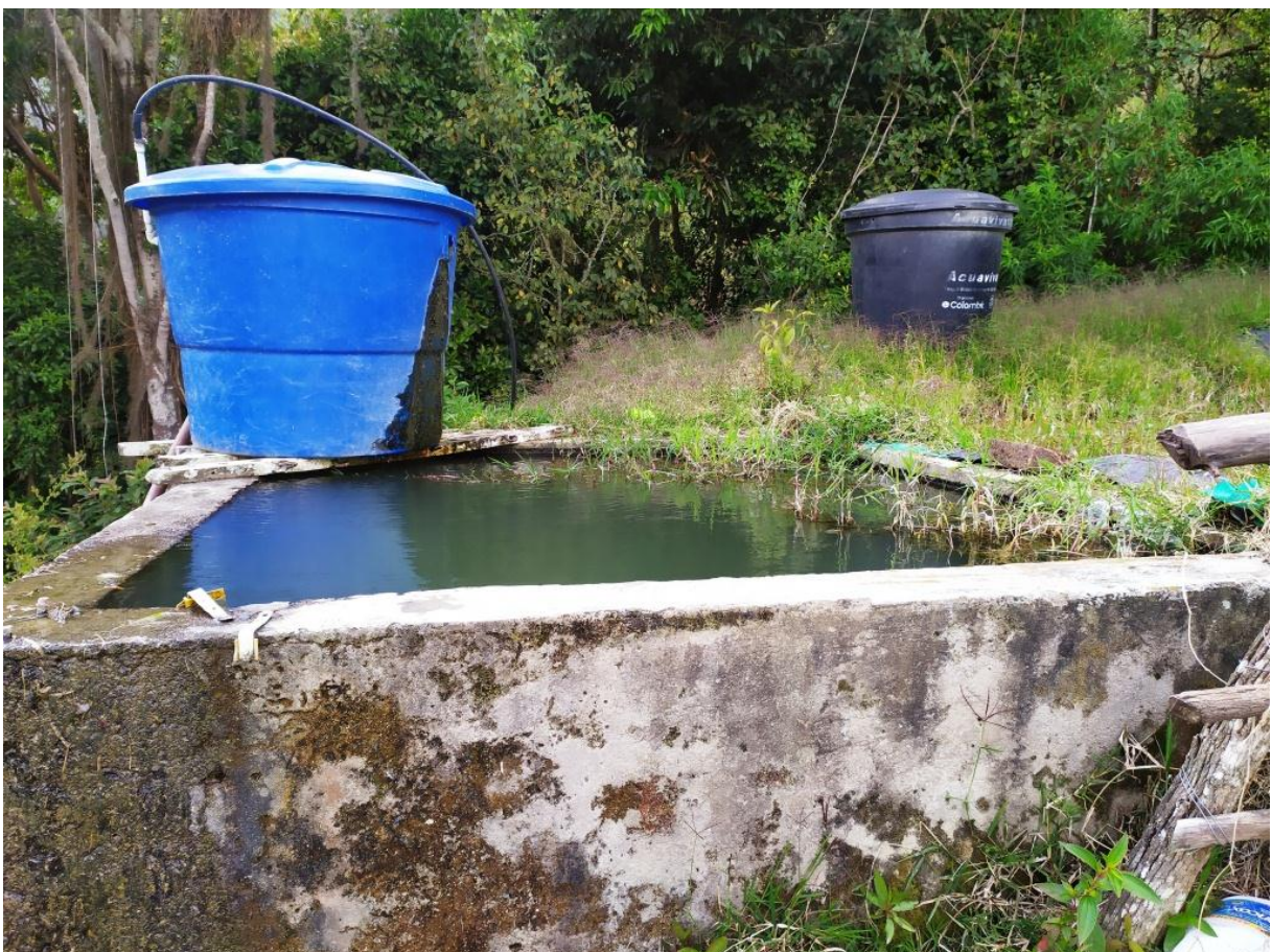
FOTOGRAFIA 11 (Reservorio de Agua).
