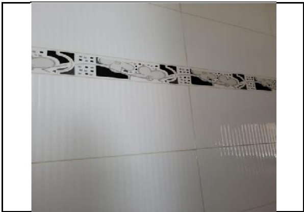
TIPO MEJORAS EN PAREDES
