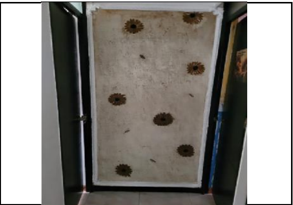
TIPO MEJORAS EN PAREDES
