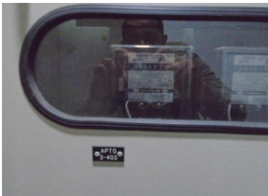
CONTADOR DE ENERGIA
