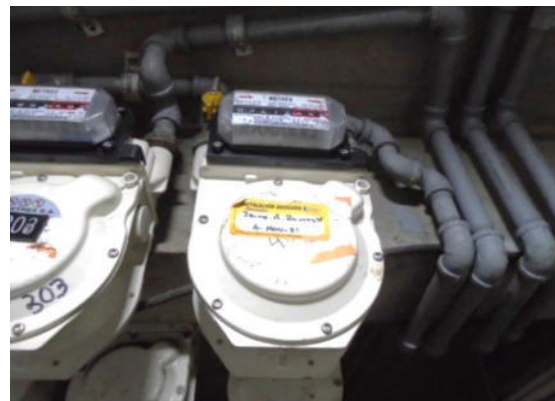
CONTADOR DE GAS
