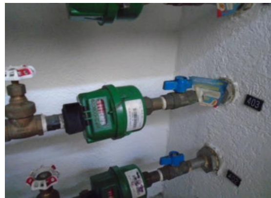
CONTADOR DE AGUA
