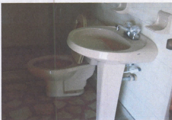
Batería baño casa mayordomo
