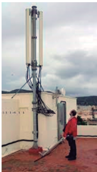
Figura 10: Mastil sobre azotea
