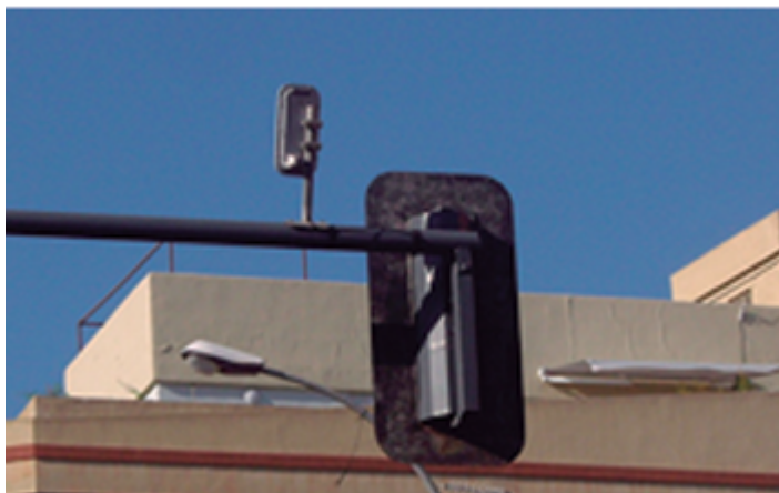
Figura 40: Picocelda instalada en semáforo y en fachada
