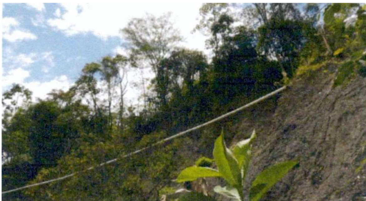
Foto: Panorámica de la tubería y el flanco derecho del deslizamiento. Zonas socavadas por la esorrentía superficial. Zona de amenaza alta de nuevos movimientos
