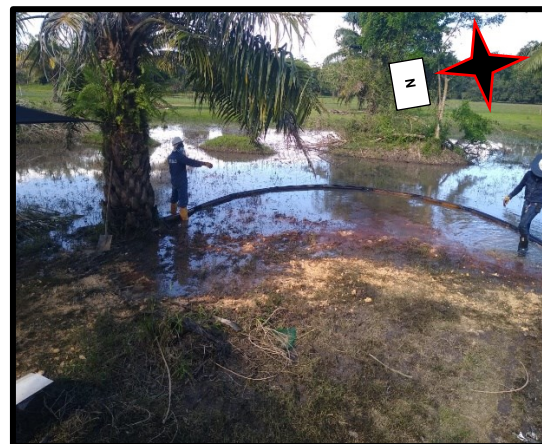
Fotografía No. 54: Plan de limpieza ambiental realizado por el personal de ECOPETROL
