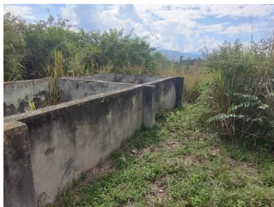
LINDERO SUR OCCIDENTE PUNTO 32 REFERENCIA TANQUE
